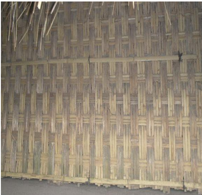
Gambar 11. Dinding/pagar tanpa ventilasi
